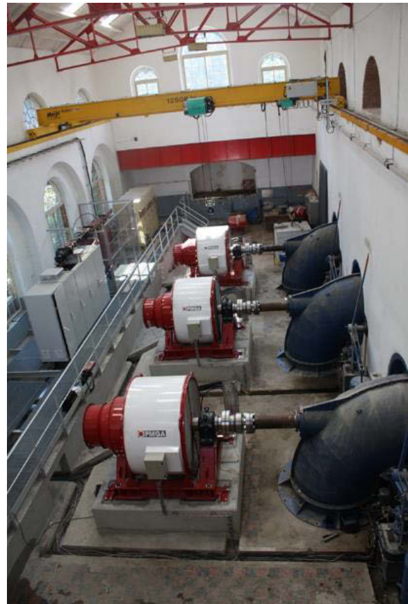
Las Rives HPP 3 Horizontal PMG 800 kW.
