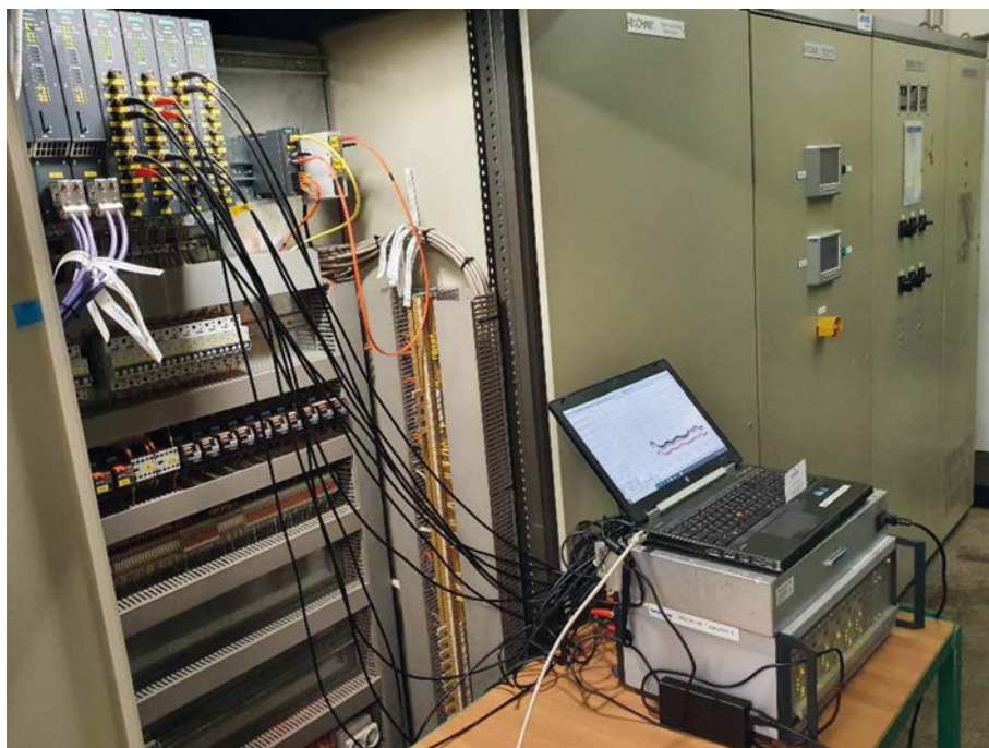
Bild 3. Temporäre Installation des Schwingungsdiagnosesystems STUDIS-SE an der Wellenschwingungsmessung bzw. den gepufferten Ausgängen des Schwingungsschutzes.
